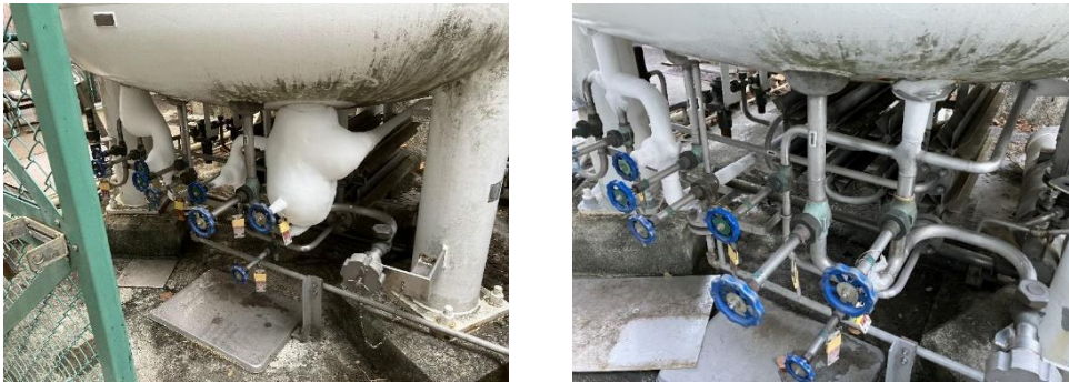
図 4. 3 液体窒素貯槽下部配管。左が電磁バルブ交換前で右が交換後。交換前は霜が大量に付いているが、交換後は霜が付きにくくなった。
