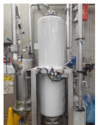
図3.4 油分離器。筒の中に活性炭が150 kg 詰められている。
