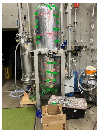
図 4.1 断熱材で覆われた油分離器。
