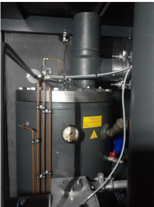
図3.1 オイルセパレーター。オイルタンク上部に入っている。
