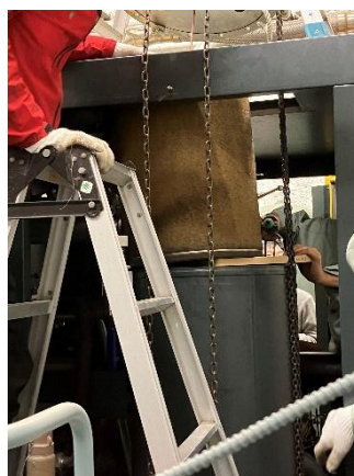
図 4.5 古いオイルセパレーター。汚れている。
