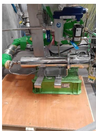
図 4.2 窒素ガス加熱用のヒーター。
