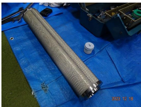
図 4.4 取り外されたコアレッサーフィルター。
