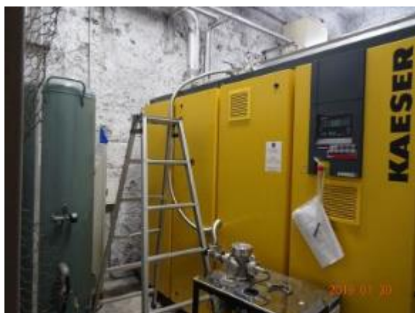
図 2 液化用ヘリウム圧縮機. 圧縮された油分を含むヘリウムガスは、各種オイルフィルターと図 3 の油分離器内部を通して油分が除去され、液化機本体に導入される。
