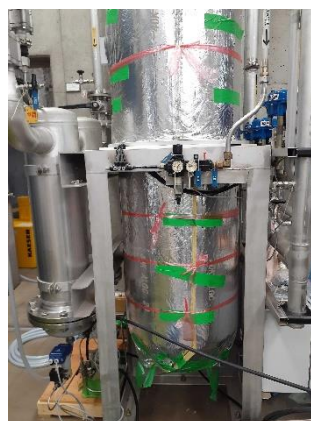
図 3 油分離器. 内部には 160 kg もの大量の活性炭が入っており、分子レベルで油分を吸着除去する。
