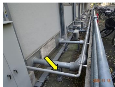
図 5. 1 南 5 号館前のヘリウム回収配管。
