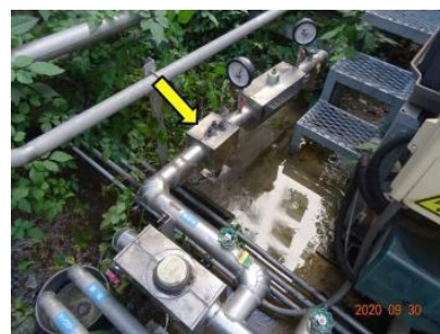
図 8.1 冷却塔給水配管の水漏れ。矢印で示す部分の中身を交換した。
