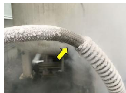
図 4. 4 液体窒素用フレキシブルチューブ。矢印の霜がついていないところから液体窒素が漏れる。
