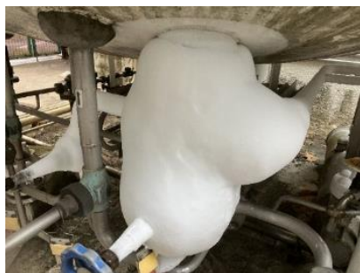
図 4. 5. 1 液体窒素貯槽下部の配管の霜。
