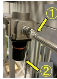
図 2. 2. 4 中圧ガスドライバーにつながる計装空気配管。泡が出ているところから漏れた(①)。減圧弁(②)からも漏れがあった。
