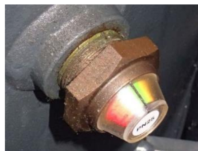
図10 液化用圧縮機のオイル液面計。圧縮機の稼働中の表示。黒い線が緑色の領域にあれば良い。
