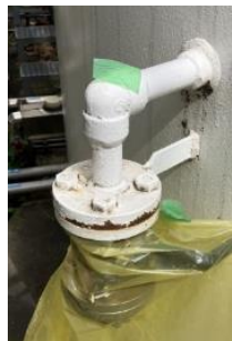
図 7.2.1 錆のある配管。
