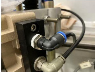
図 2. 2. 3 計装空気のエルボ継手。上側が新しく交換した継手。
