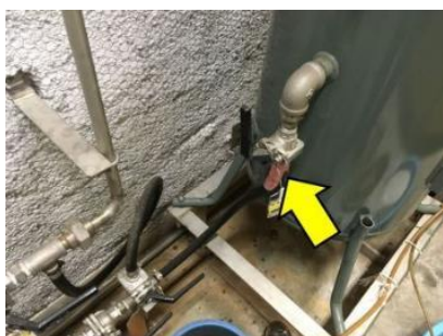
図 2.2.1 矢印部分でゴムチューブがさけ、ガスが漏れた。
