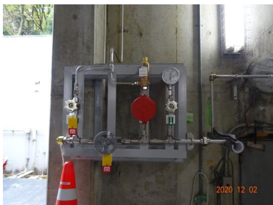
図3 すずかけ台液化室に新設された高圧ガス移送用の高圧ガス配管設備の一部。
