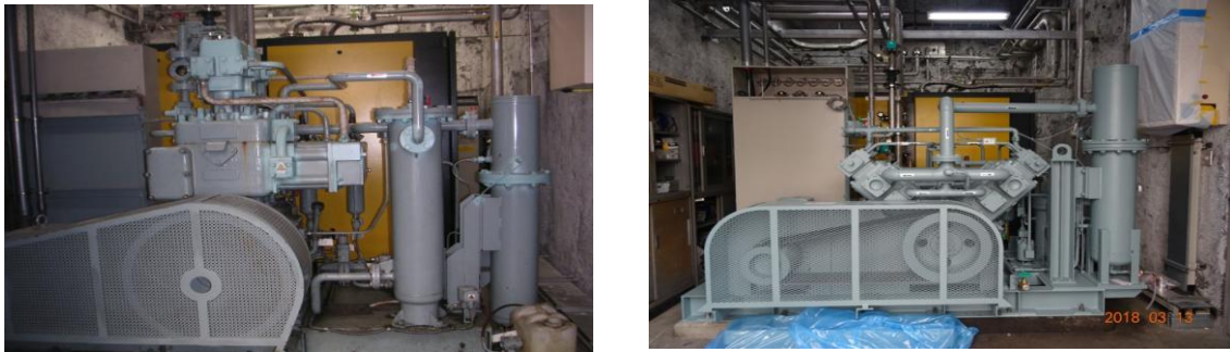
図1 新旧圧縮機の比較 左:旧圧縮機 右:新圧縮機
